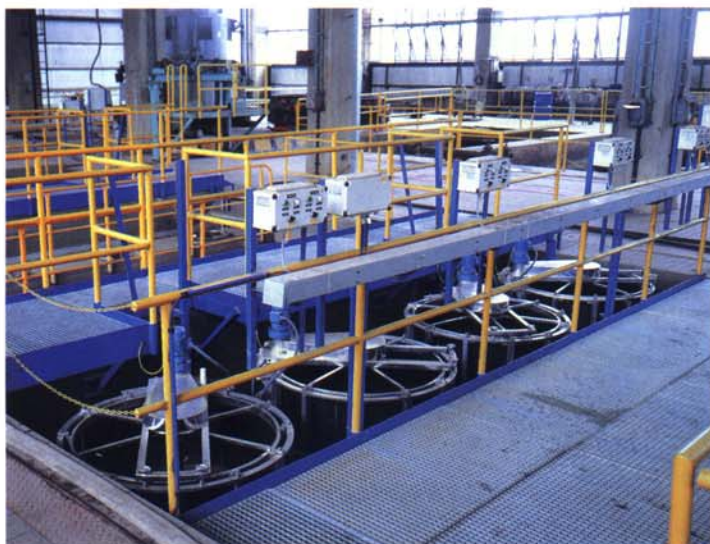
Filtrační stanice v elektrárně
