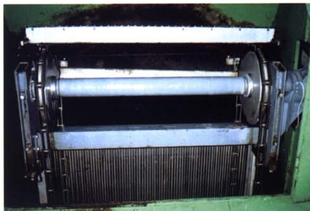
Řetězové česle v elektrárně
