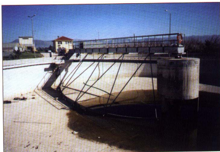
Dosazovací nádrž na ČOV, Kypr
