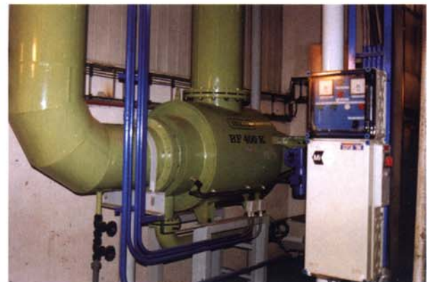
Filtrační stanice chladící vody v elektrárně
