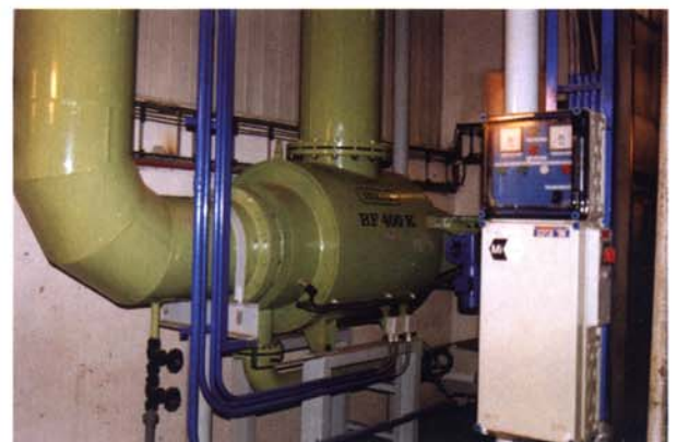
Filtrační stanice chladící vody v elektrárně
